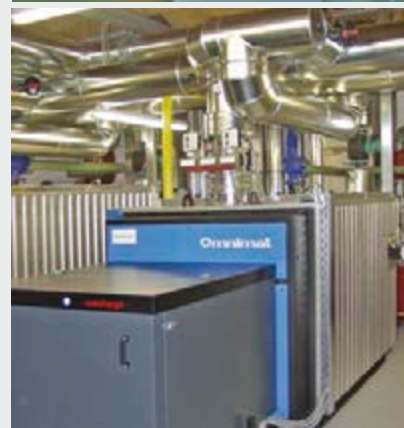
von oben nach unten: Außenansicht mit Heizzentrale; Kesselanlage
