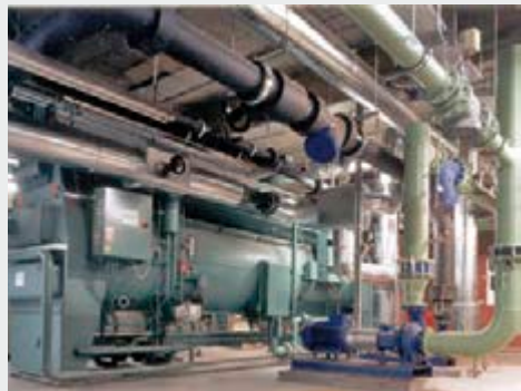
von oben nach unten: Außenansicht; Alter Kessel; Neuer Kessel; Neue Kältemaschine
