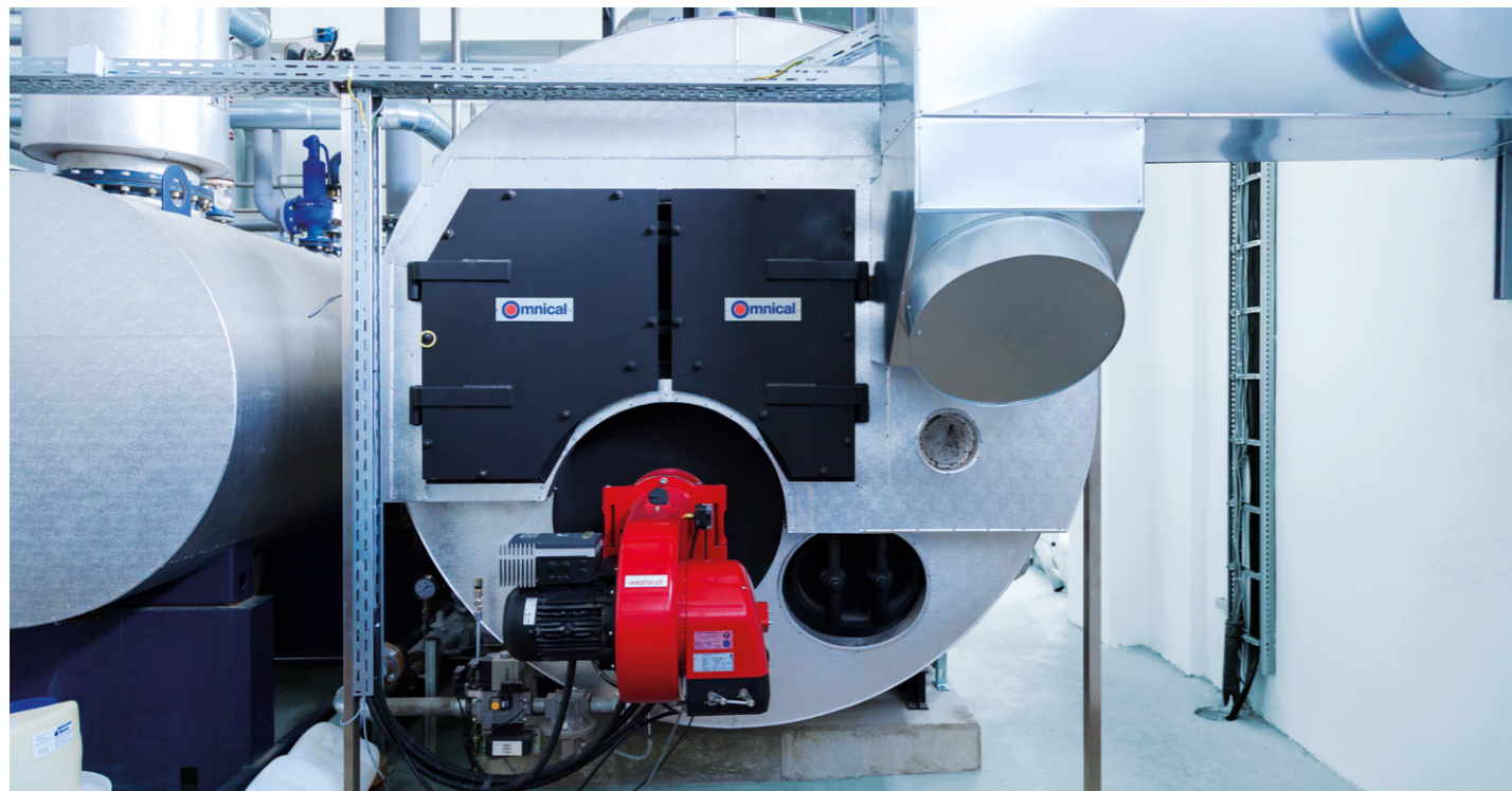
Mit der Wärme aus einer Mikrogasturbine wird in diesem Kessel Dampf für die Konfitürenherstellung erzeugt. | Foto: Stadtwerk Haßfurt
