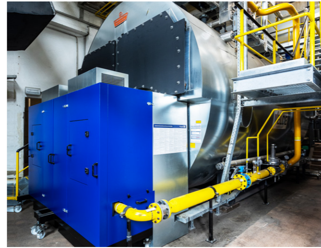
Im Vordergrund: die Dampfdruckregelanlage für den Standardkessel. | Foto: swb AG
