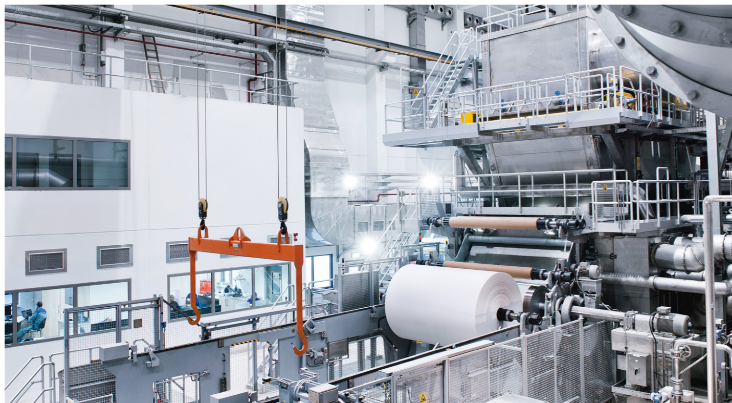
Die Papiermaschinen am Standort Miltenberg der Fripa KG nutzen Erdgas unter anderem für die Papiertrocknung. | Foto: Fripa
