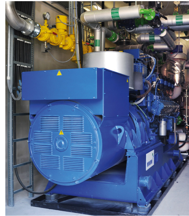
Das Blockheizkraftwerk, das in Willingen ein Hotel und mehrere kommunale Gebäude mit Wärme versorgt. | Foto: EAM EnergiePlus GmbH
