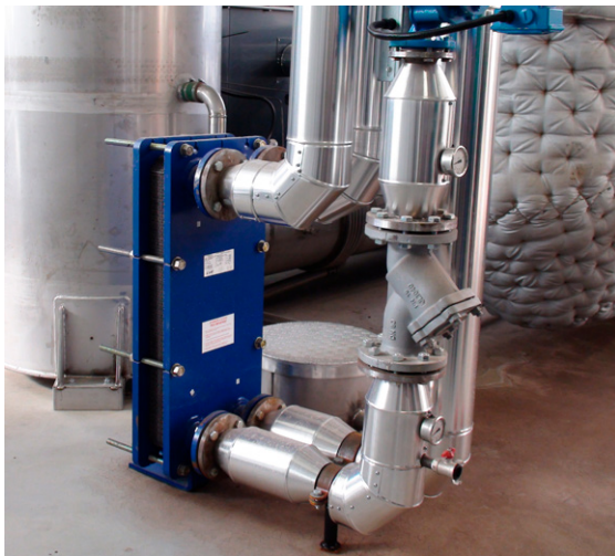
Abbildung 16: Plattenwärmetauscher zur Systemtrennung Heizkessel-Gewächshäuser
