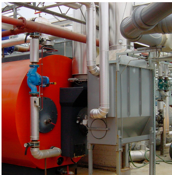
Abbildung 22: 2 MW-Erdgaskessel mit nachgeschaltetem Abgaskondensator
