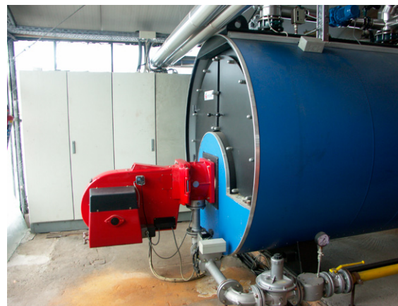
Abbildung 19: Erdgasheizkessel im Gartenbau
