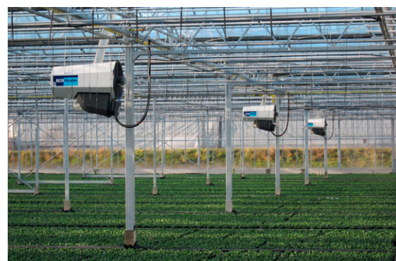
Abbildung 6: Gewächshausbeheizung mit speziellen Erdgas-Heizkanonen
