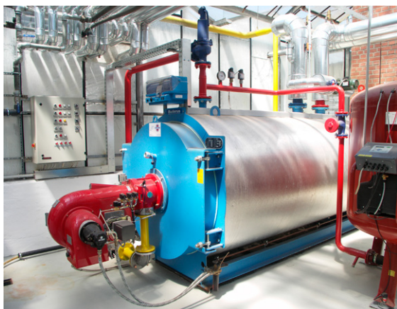
Abbildung 20: Gartenbaukessel mit Kombibrenner Öl-Gas
