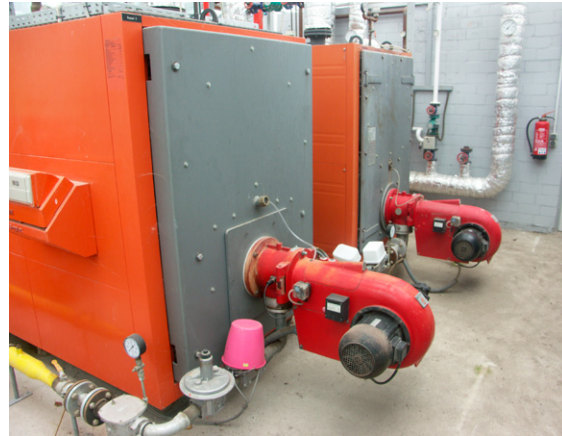
Abbildung 7: Zweikesselzentrale in einem Gartenbaubetrieb
