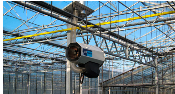
Abbildung 14: Erdgas-Heizkanone mit Frischluftansaugung von außen
