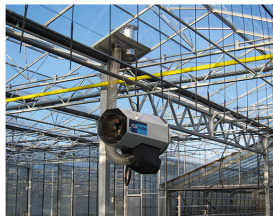
Erdgas-Heizkanone mit Frischluftansaugung von außen (Foto: Dipl.-Ing. Otto Domke)
