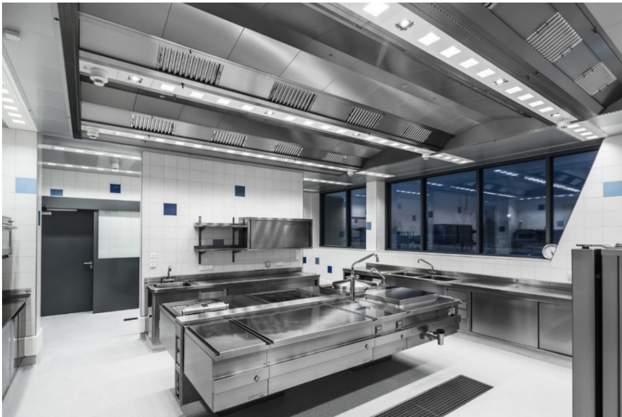
Abbildung 14: Lüftungsdecke in einer Zubereitungsküche
