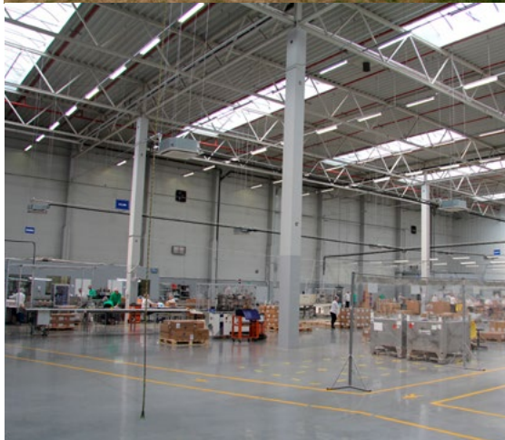
Abbildung 22: Lagerhalle mit Gasmotor-Wärmepumpen
