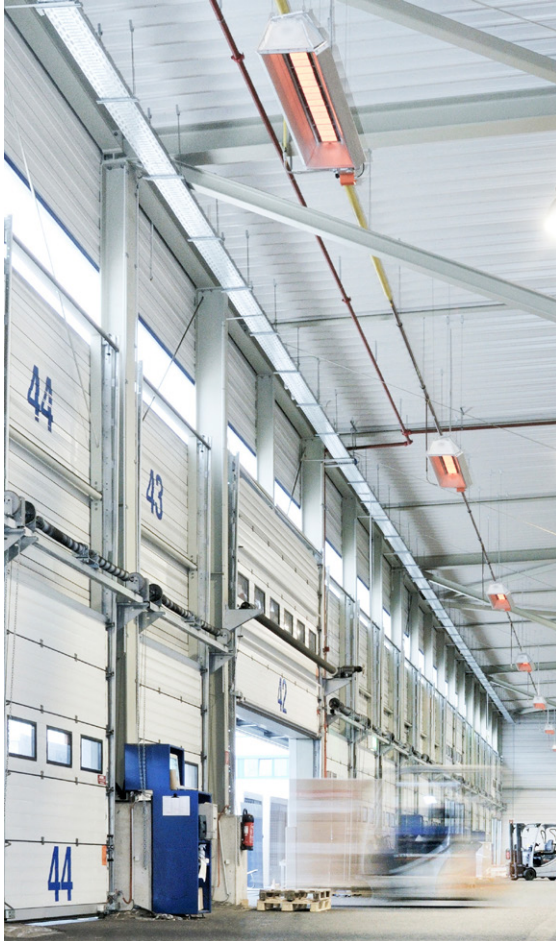
Abbildung 18: Verladebereich mit Hellstrahlern (Modell Schwank supraSchwank mit seitlich in den Reflektor integrierter Mischkammer [vgl. Abbildung 6] und wärmegeämmtem Reflektor)
